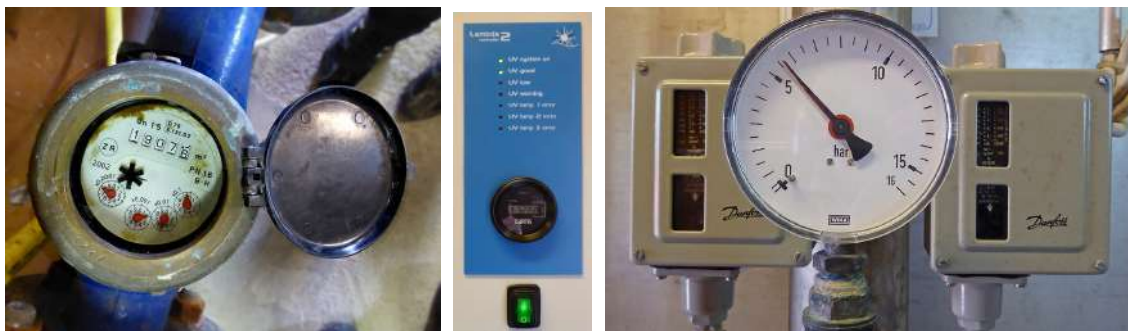
Figur 32. Utgående vattenmätare, UV-filtrets gångtid samt utgående tryckmätare i vattenverket
