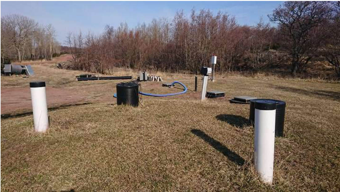
Figur 23. Hellsö reningsverk byggdes 2012 och är dimensionerat för 120 personer. Det finns två inkommande kammersystem, ett för kommunalt anslutna och ett för septiktanktömning. Systemet fungerar optimalt under högsäsong då inflödet är högre och jämnare. Under lågsäsongen är det mindre tillflöde varpå systemet stänger av sig och de nedbrytande bakterierna dör. Detta leder till nedsatt rening och kräver större tillsats av kemikalier. Källa: Lotta Eriksson, 2019
