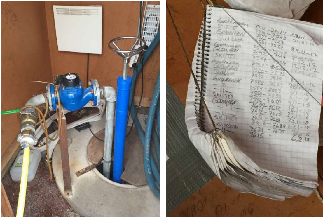
Figur 13. Skärgårdsfärjornas vattenbunkring. Till vänster är den anslutning som används när färjorna bunkrar vatten från Kökars kommunala vattenledning. Bilden till vänster visar den loggbok i vilken det noteras vilken färja, mätarens ställning och datum för uttag. Källa: Christian Pleijel.
