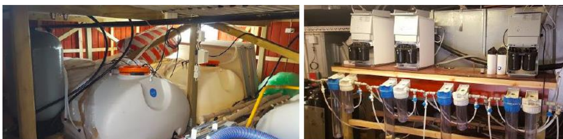
Figur 22 KSSS avsaltningsanläggning. Vänster: Vattentankar i plast samt grå hydrofortank. Höger: Filterstation. (Foto av författaren den 6 april 2019)
