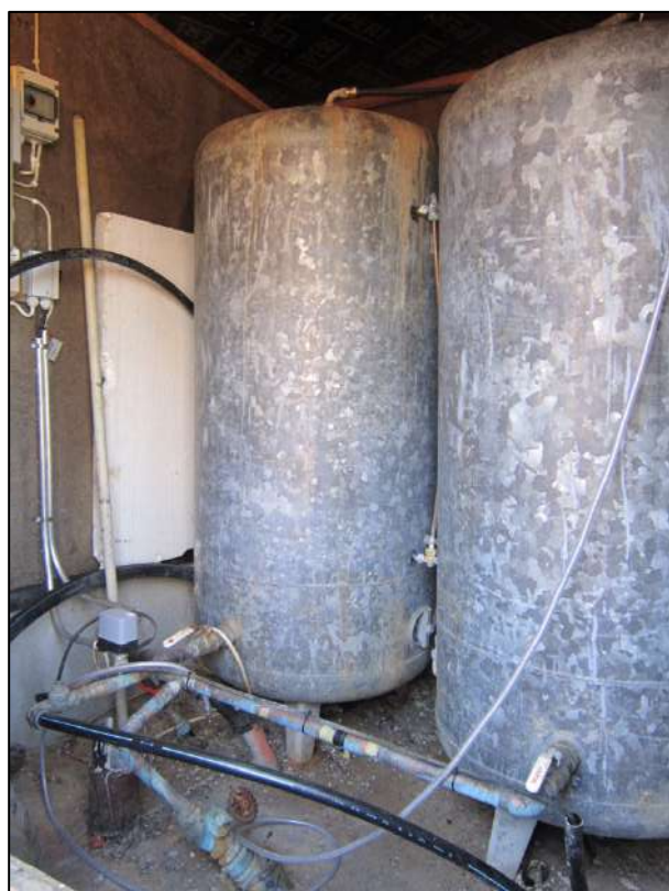
Figur 10. Vy inifrån Torsholma Vattenbolags pumphus med de två hydroforerna. Det gamla brunnshålet är det svartgråa röret som sticker upp ur golvet till vänster i bild.
